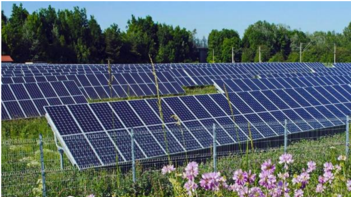
normaler Solar-Park in Süd-Deutschland
